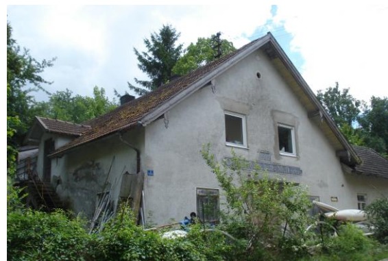
Abb. 131: Sanierungsbedarf alte Molkerei
