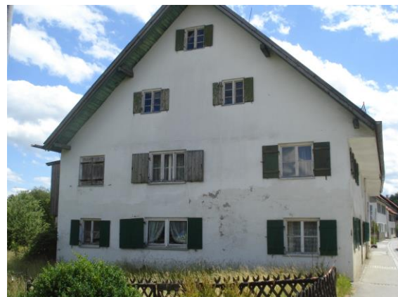
Abb. 105: Gebäude mit Sanierungsbedarf an der Hauptstraße
