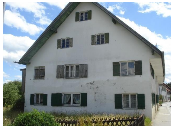
Abb. 23: Sanierungsbedürftiges, ortsbildprägendes Gebäude an der Hauptstraße
